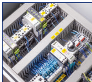
Controlador de contactores
