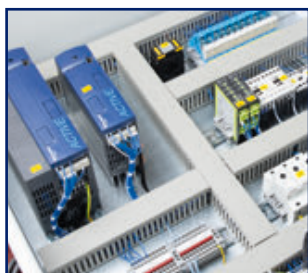
Sistema de control del convertidor de frecuencia
