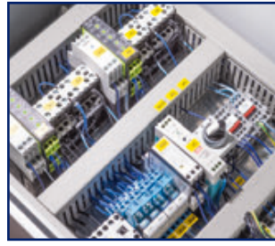
Controlador de contactores
